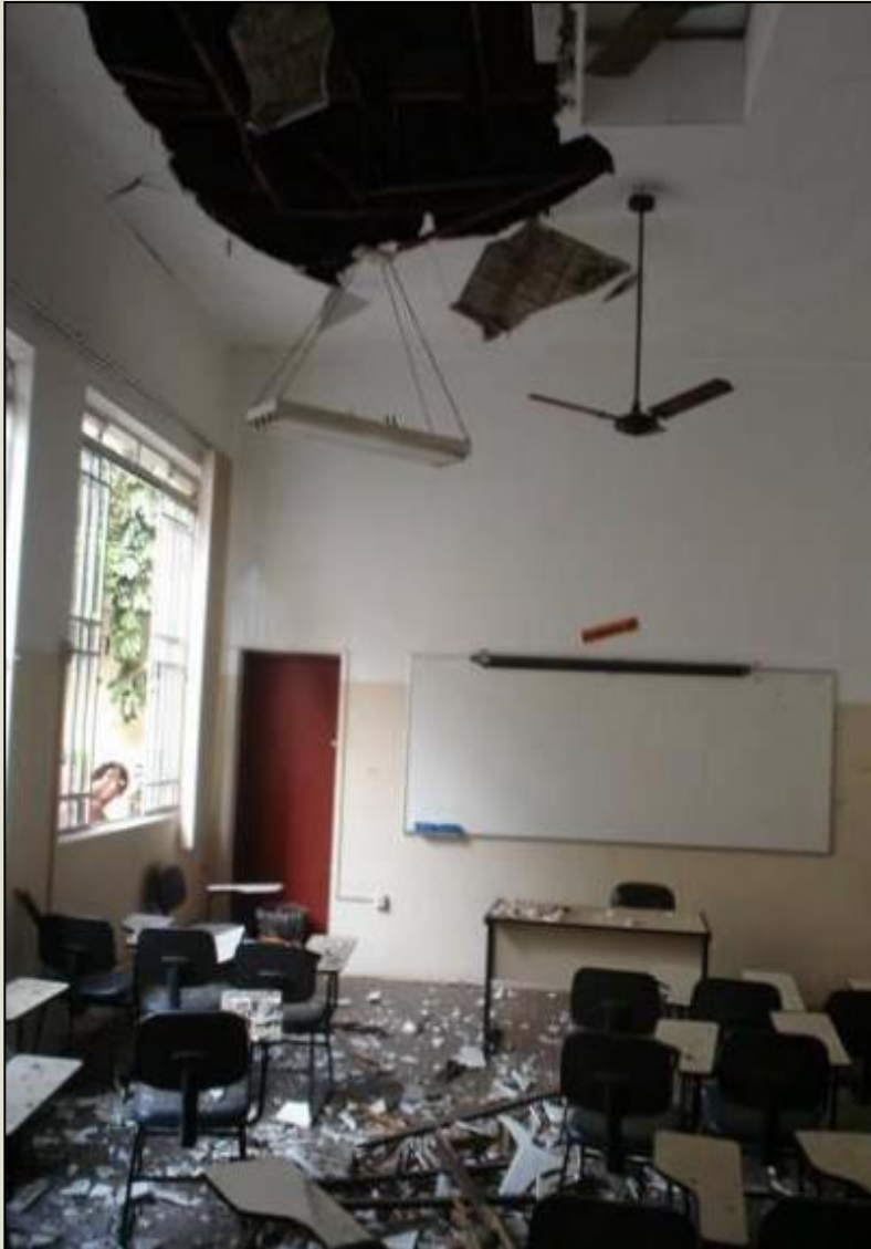
Quede de Forro
