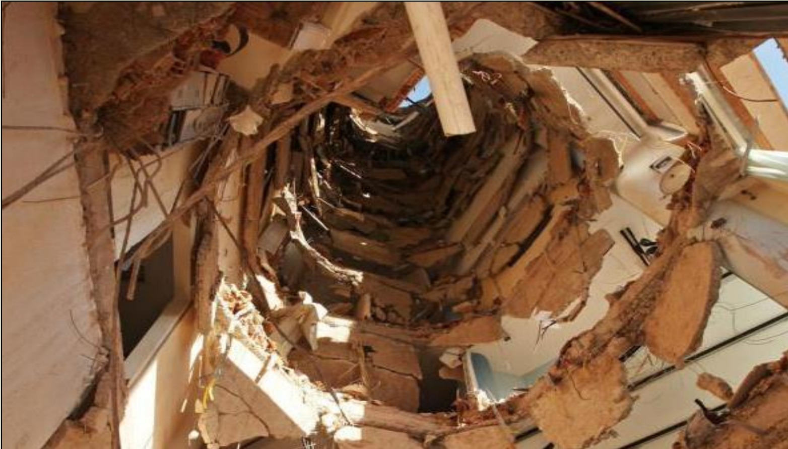
Edifício da Avenida Índico - São Bernardo do Campo/SP Desabamento Parcial
