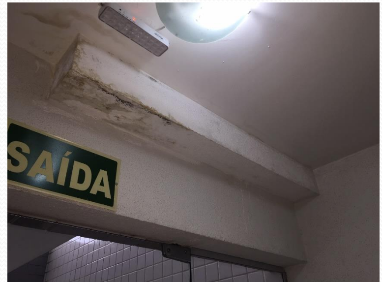
Imagem registrada com câmera convencional - Infiltração Fonte: O Autor (2020)
