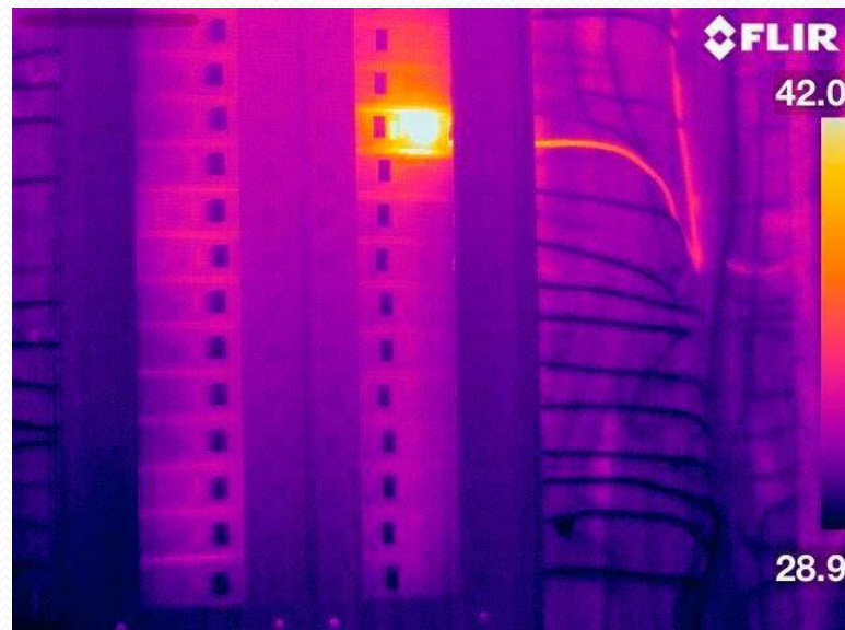
Identificação de disjuntor com comportamento divergente dos demais Fonte: NM Consultoria (2019)
