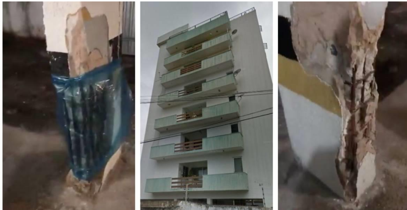
Desabamento em Fortaleza por conta de reforma inadequada (Outubro/2019)
