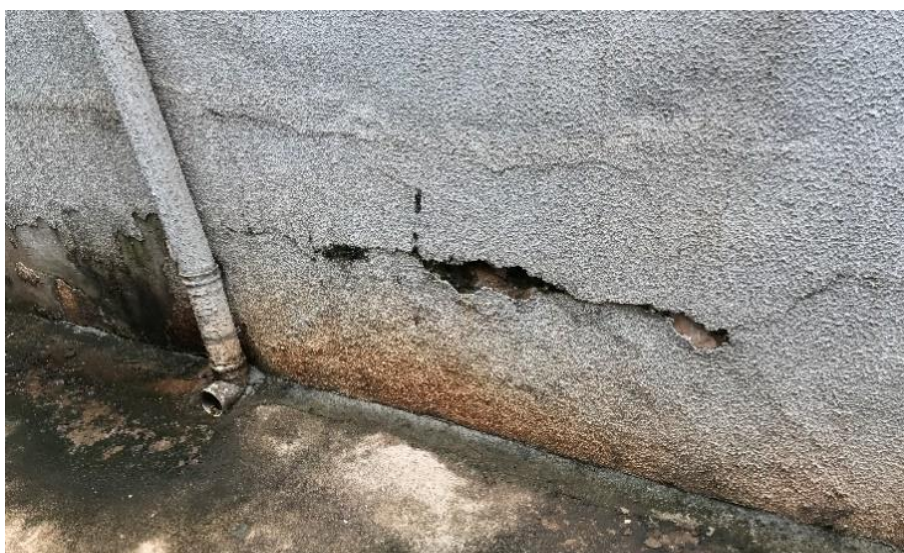
Figura 13 – Parede externa em alvenaria com fissuras e umidade ascendente.
