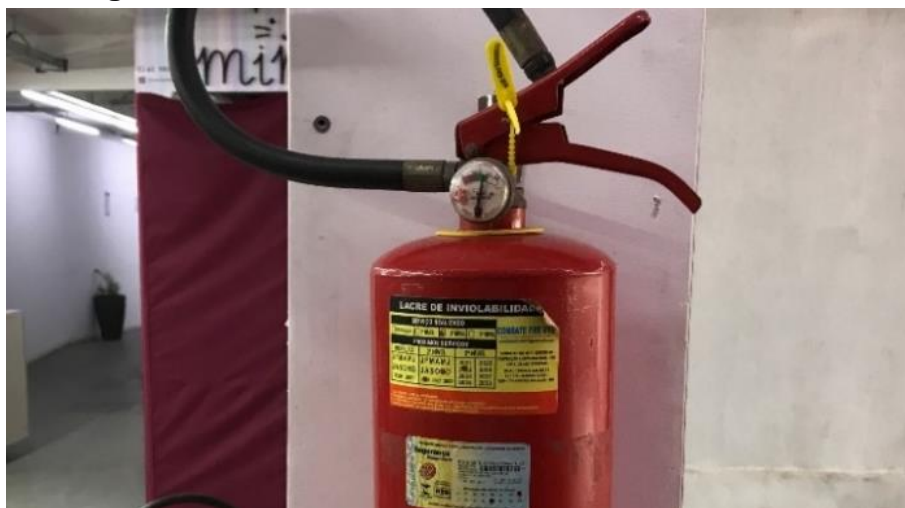
Figura 17 – Extintor com data de validade vencida.
