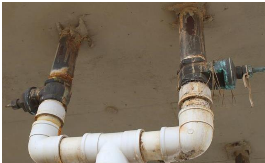
Figura 18 – Tubulações do barrilete com vazamento.
