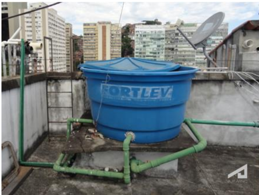
Reservatório superior e caixa complementar
